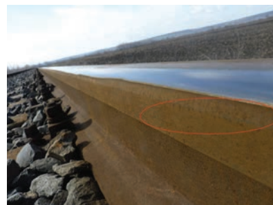
5. ábra. 106+78 jobb sínzál deformálódása
