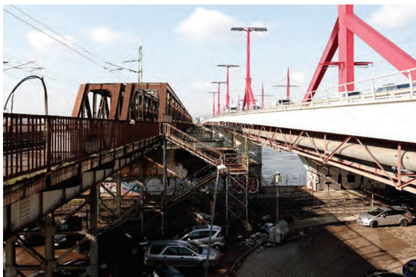
1. ábra. A Rákóczi híd és a meglévő vasúti híd közötti szűk munkaterület
