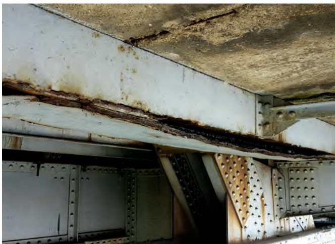
16. kép. Erősen korrodált hídszerkezet
