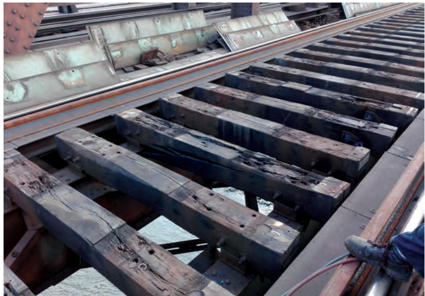
7. ábra. A Déli összekötő vasúti híd repedt hídgerendái
