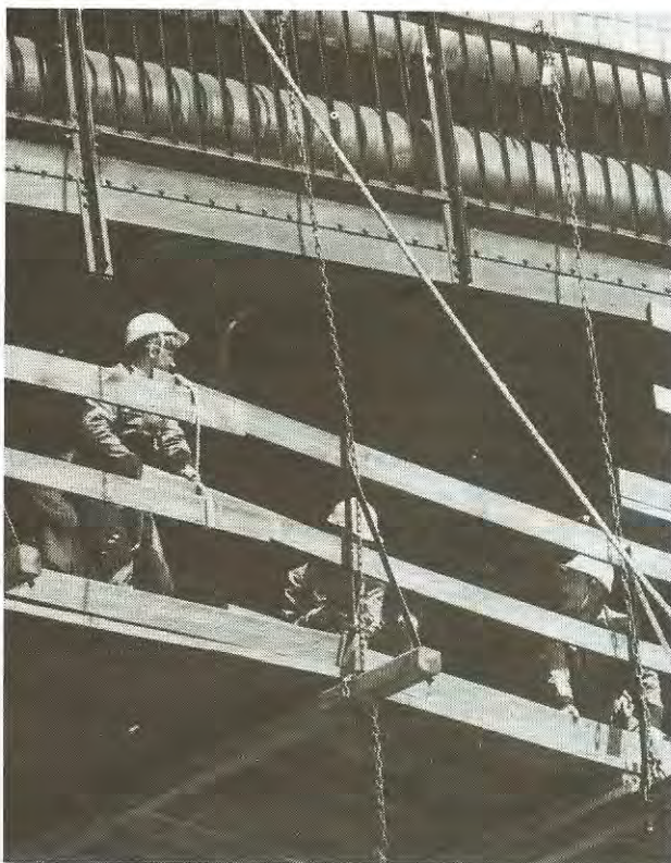
1. ábra: Déli összekötő Vasút Duna-híd bal vágány alsó öv mázolásához állvány építés
