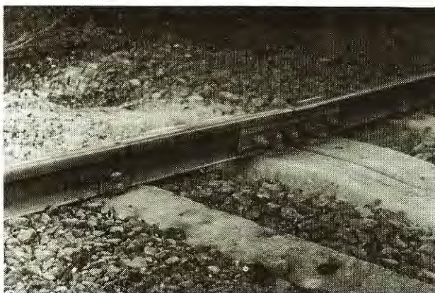
3. ábra Elvert sínvég, berágódott alj
