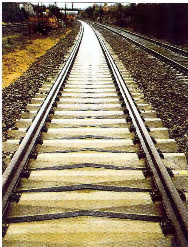
2. ábra. A széles betonaljás vágány a lefedő műanyag csíkokkal
