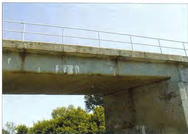
1. ábra. A hídszerkezet korróziója
