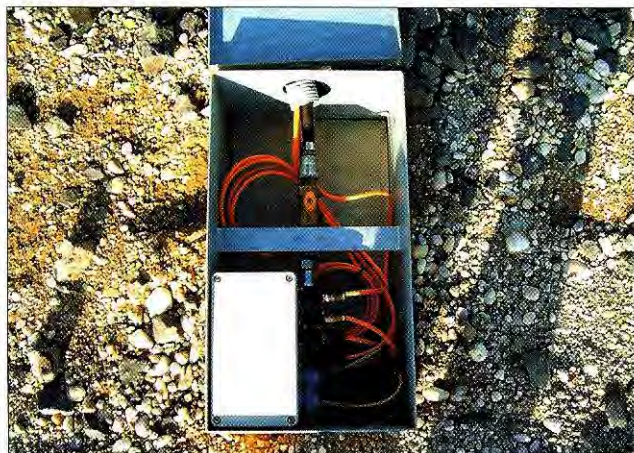
11. ábra. Csatlakozó szekrény nyitott fedéllel
