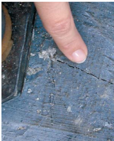
18. kép – A bordás kiegyenlítő lemez repedése
