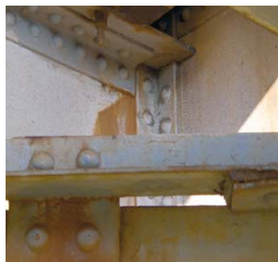
2. kép – Repedés képe a felfedezésekor
