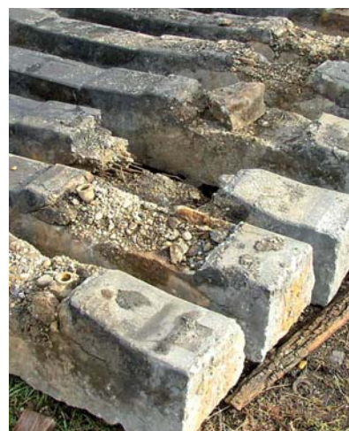
3. kép. A Komárom állomás páratlan oldali útátjárójából kivett LW-aljak sín alatti részeinek sérülései
