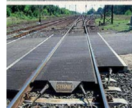
5. kép. Gumielemes közúti-vasúti átjáróburkolat szegélybordával
