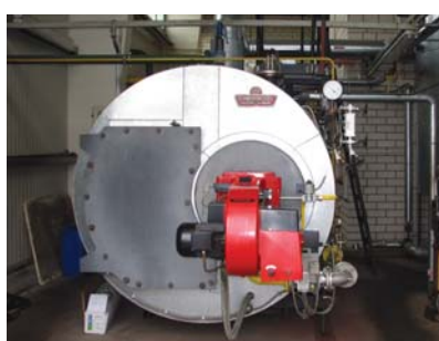
5. ábra. Utóégető berendezés FOTÓK: BABOS REZSŐ
