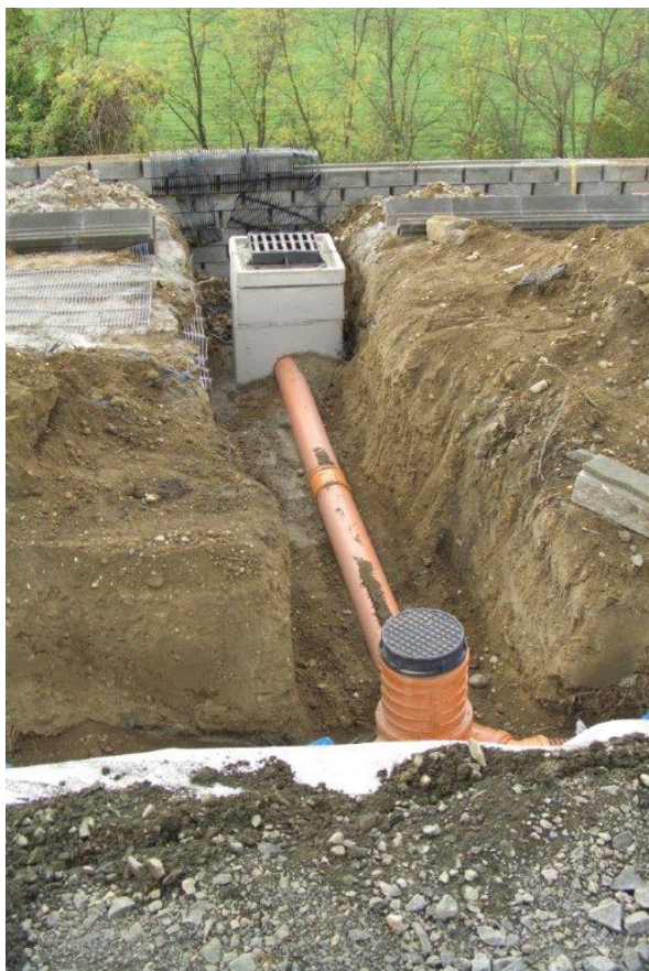
10. ábra. Keresztcsatorna a hordalékfogós víznyelő aknával (Fotó: Pokorný Bence)
