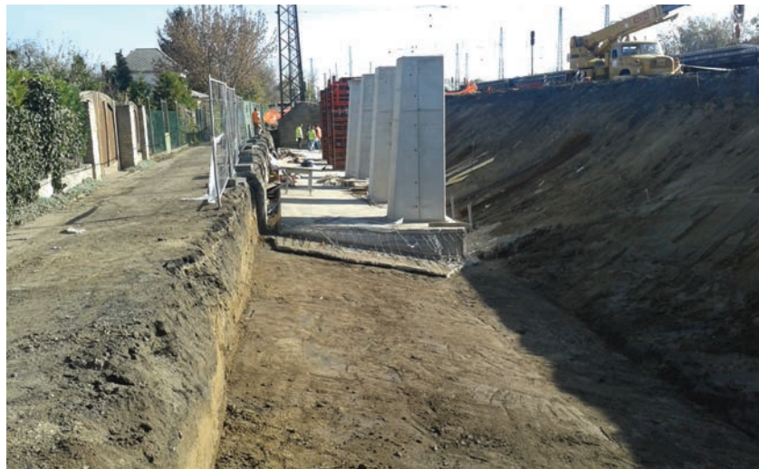
5. ábra. A MÁV telep utca az építkezés idején (Fotó: Szeifert Tamás)
