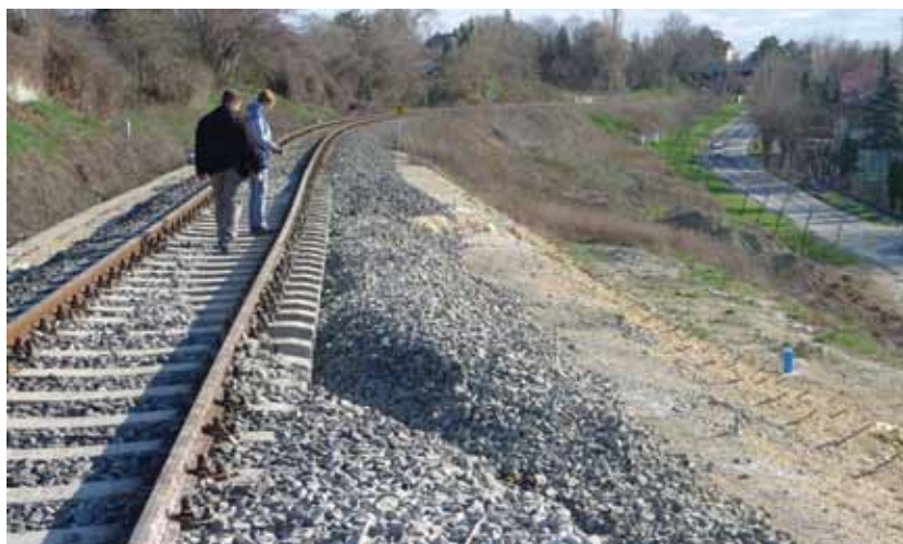
1. ábra. Balatonakaratyai töltéscsúszás, 2010
