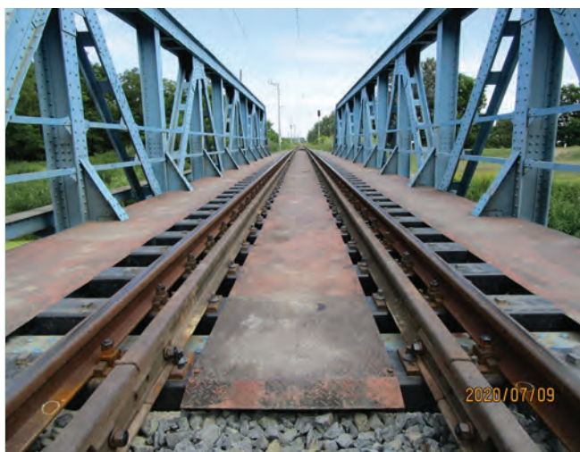
7. ábra. Beépített hídgerenda Hanságligeten
