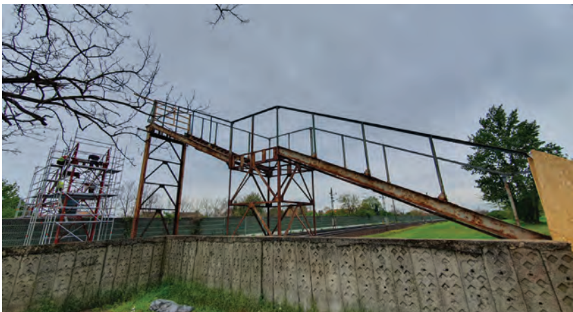
6. ábra. Gyalogosfelüljáró felújítás előtt Vecsés–Üllő állomásközbén
