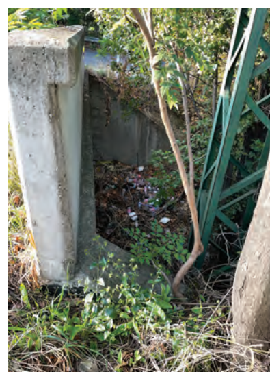
6. ábra. A Keleti pályaudvartól a metró felé vezető vágány elhanyagolt környezete. (Fotó: Tóth Zsolt)
