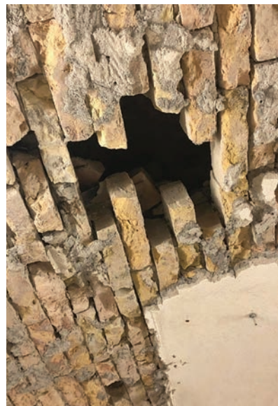
10. ábra. „A” épületrészben a bontási munkálatok során tapasztalt födém-meggyengülés
