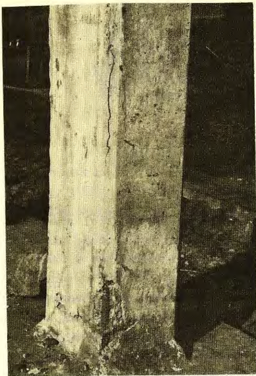
1. ábra. Vasbeton oszlopláb a jellegzetes meghibásodásokkal
