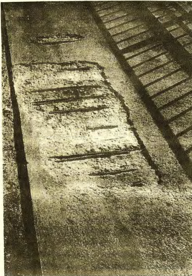
6. ábra. Vasúti vasbeton hid meghibásodott gyalogjárójának a laza betonrészek-től már megtisztított felülete
