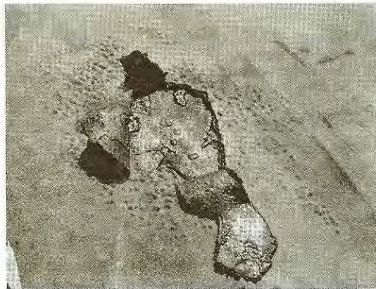
2.kép A felhólyagosodott szigetelőlemez alatt vízcseppek vannak
