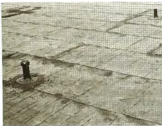
3.kép A szigetelőlemezek keresztirányú repedései a helytelen szállítás és tárolás következményei
