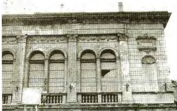
3. ábra A pálya felőli csarnok-homlokzat, hiányzó díszítőelemekkel, erősen málló vakolattal
