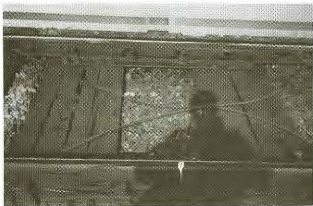
5. ábra A ligetéri hídnál záródott dilatációs készülék
