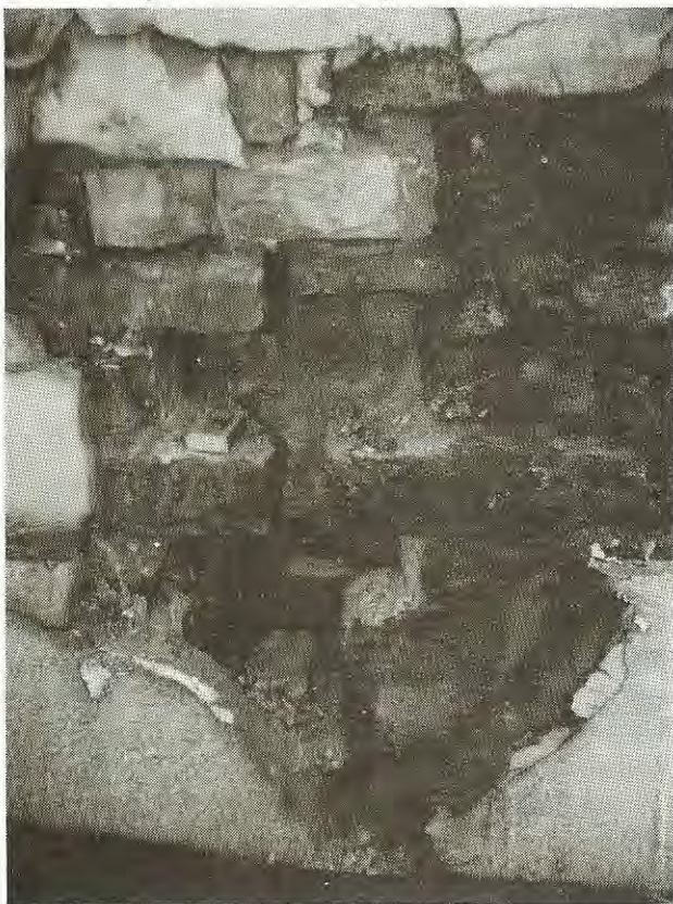
6. ábra A falazat károsodása
