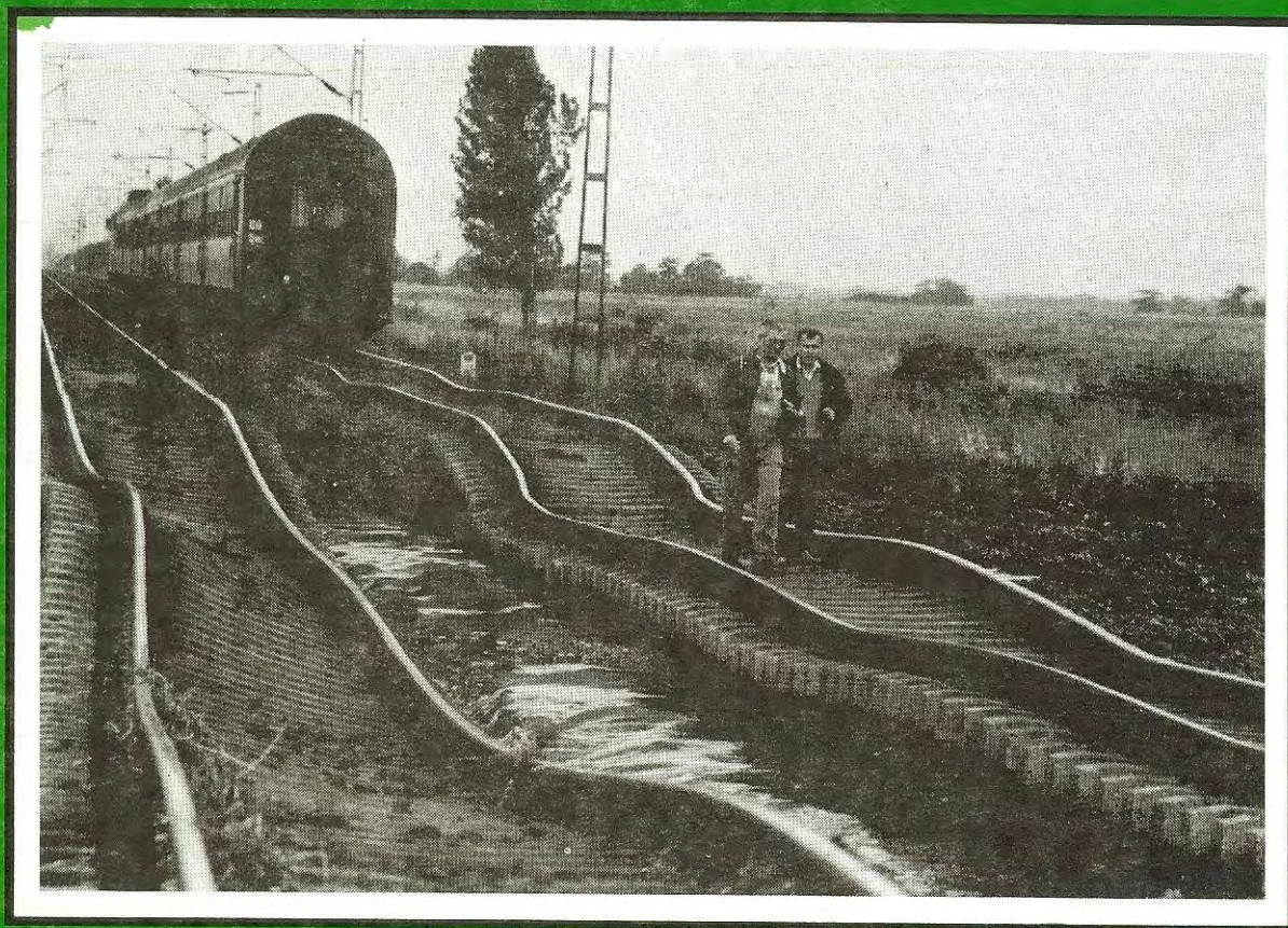
Nagyút – Kál-Kápolna állomásköz károsodása
