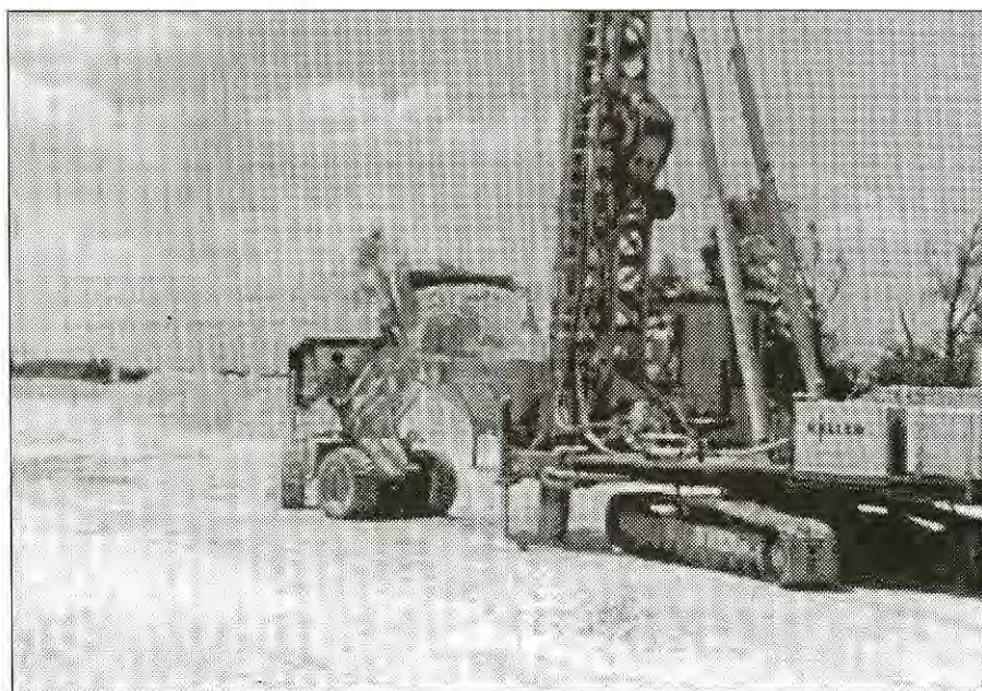
13. ábra. Vibro kavicscölöpgép az anyagtartályból a zsilipen keresztül zúzalékot tölt a vibrátorba (283-288 szelv. között)
