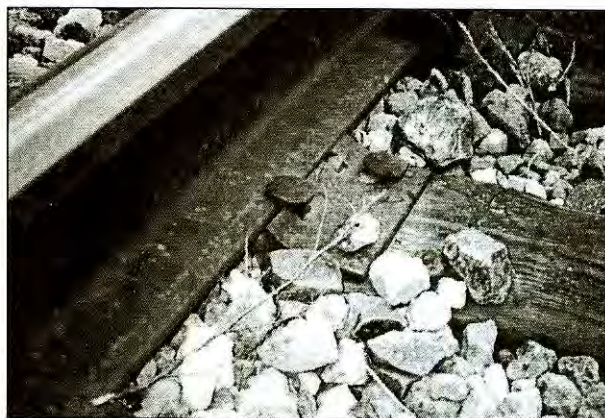
2. ábra. Jó állapotban lévő sínszeges sínleerősítés
