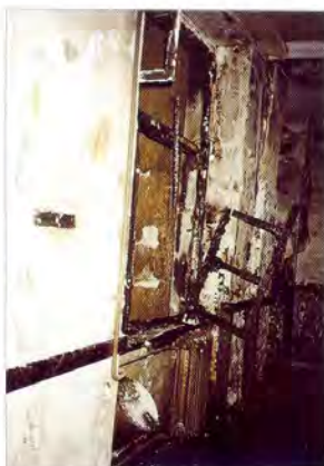
3. ábra. Kiegtett aknaablak az ötödik emeleten, a tűz feljutásának helye
