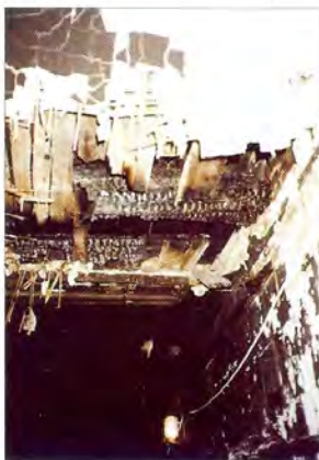
2. ábra. Az átégett ötödik emeleti folyosófödém
