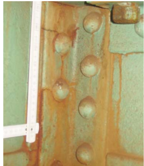
4.2 kép – Fáradási repedés a novajdrányi híd hossztartó bekötésénél
