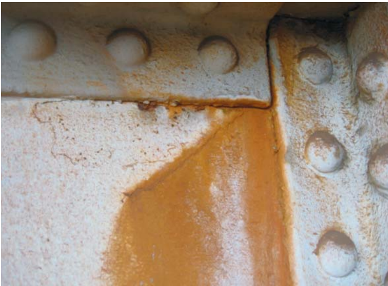
4.1 kép – Fáradási repedés a rétszilasi híd hossztartó bekötésénél
