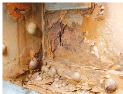
5. ábra – Korróziós károsodás a pályatartónál
