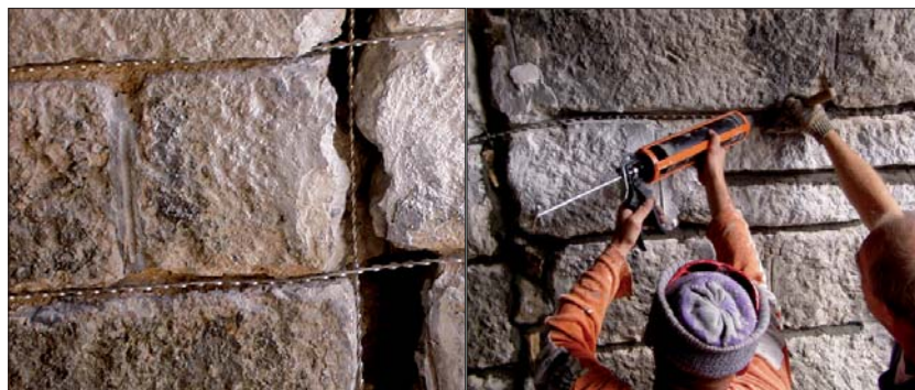
6. ábra. Homlokfal erősítés rozsdamentes spirálacéllal
