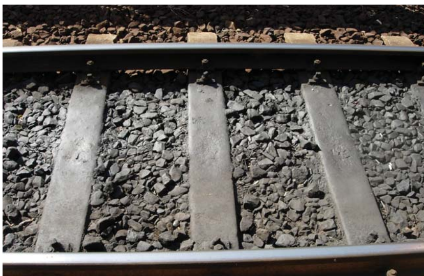
3. kép. Állomási vágány olajszenyezett állapotban (1)
