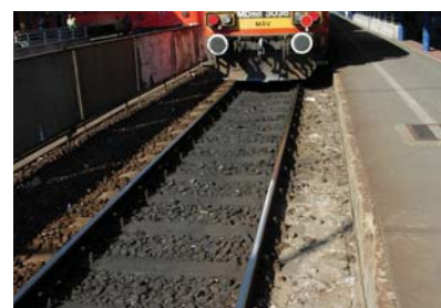
4. kép. Állomási vágány olajszenyezett állapotban (2)
