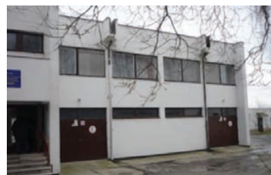
5. ábra. Karbantartásra váró bátaszéki épület
