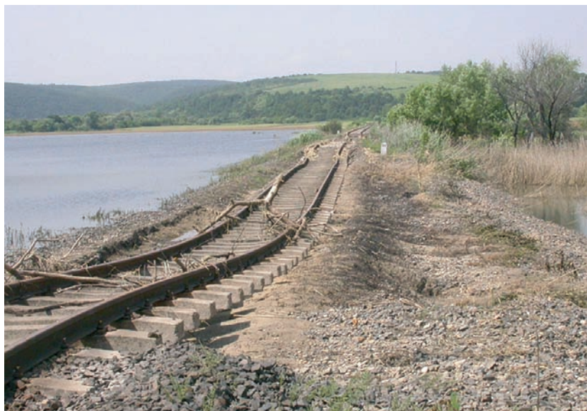
11. ábra. Vasúti pálya az árvíz levonulása után
