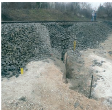
4. ábra. Repedés a rézsúmozgás helyén
