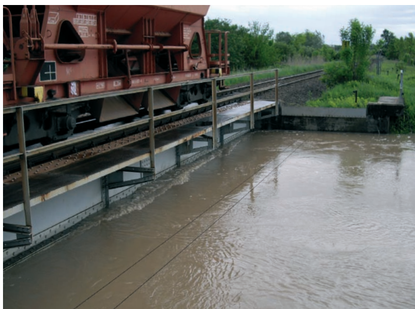
3. ábra. Apc-Zagyvaszántó állomások, a Szuha patak leterhelt hídja
