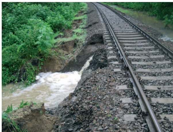
7. ábra. Vízesszerűen bukkott át a víz a töltéskoronán Szécsény közelében
