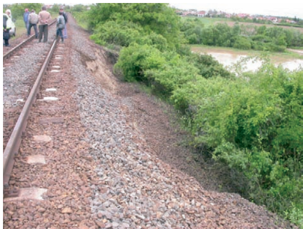
3. ábra. Rézsűcsúszás Olaszliszka, Tolcsva és Sárospatak között
