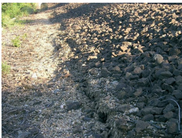
8. ábra. Megcsúszott a rézsűfelület, hosszanti repedés a padkán Vác és Verőce között
