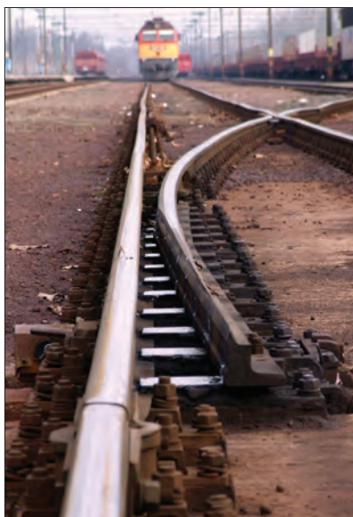
35. ábra. A 31. sz. kitérő, mögötte az irányhibás csatlakozó zúzott-köves pályaszakasz
