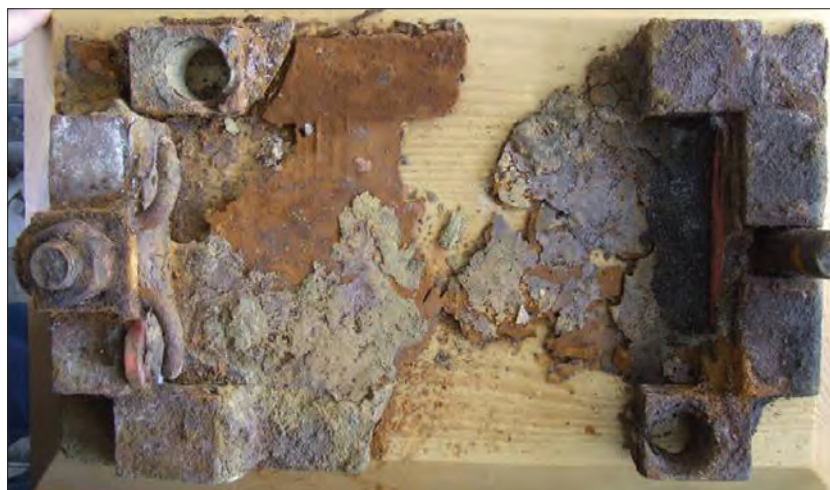
5. ábra. Korrodált alaplemez a 3-as metróból
