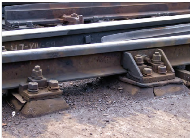
18. ábra. Jellegzetes repedések, gumilemez kitüremkedése
