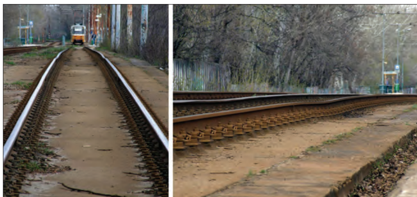
10–11. ábra. A hírhoz csatlakozó megsüllyedt pályalemez
