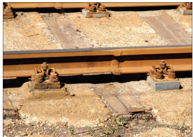
33. ábra. Szórványosan végzett felújítás
