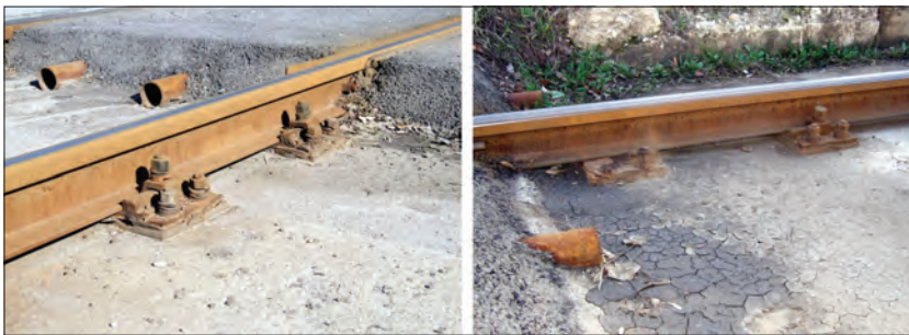
24–25. ábra. A rossz vízvezetés miatt fellépő erőteljes korrózió
