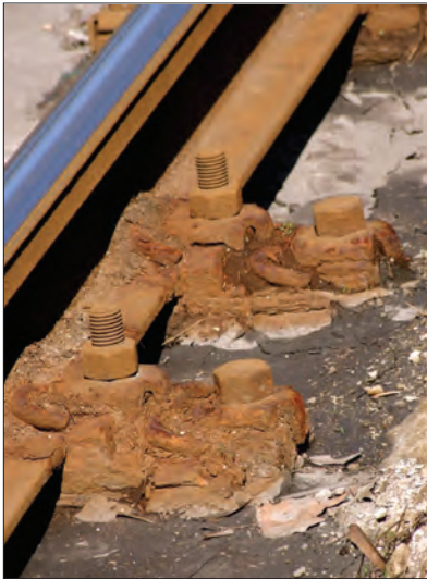
30. ábra. Erősen korrodálódott sínleerősítések
